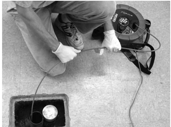
Figura 29 – Si la lazada del cable -entre el acceso al desagüe y el microReel- es excesiva, puede doblarse el cable mientras se lo devuelve al tambor
