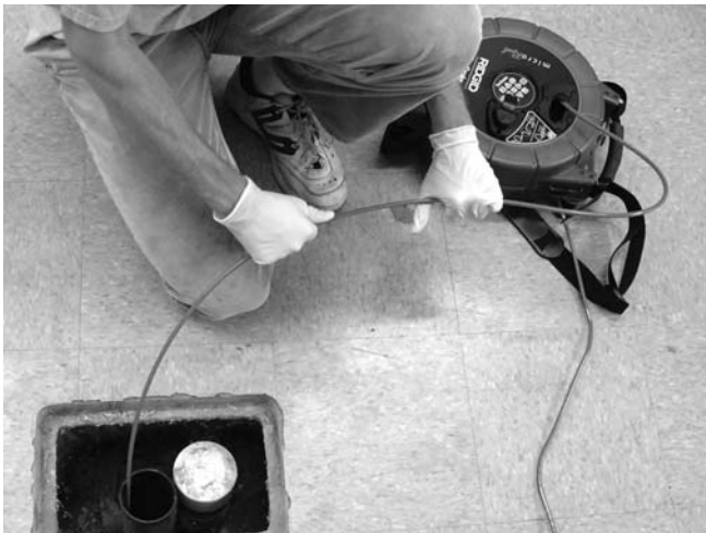
Figure 29 – Un câble bouclé risque de se plisser lors de son rembobinage
